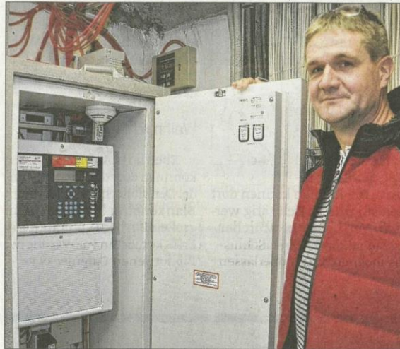
Ralf Ehrhardt ist Technikchef im Diakonie-Krankenhaus Elbingerode. Hier erläutert er die Brandmeldezentrale im Keller des vor zweieinhalb Jahren eröffneten Seniorenzentrums Friede. Foto: I. Mehlhose
